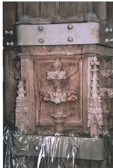
Bild 3 Die provisorischen Stahlhilfskonstruktionen (im Bild oben und unten erkennbar), welche nach der Rissbildung eingebaut wurden, konnten nach erfolgter Sanierung demontiert werden.
